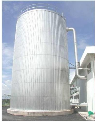
TES WATER TANK
